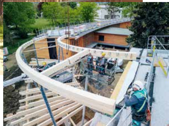
Das Team der Graf-Holztechnik hat kürzlich intensiv an der Montage der Zwischendächer gearbeitet.
