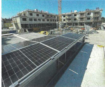
Photovoltaikanlagen auf den Dächern von Baucontainern produzieren einen Teil der benötigten Strommenge.
