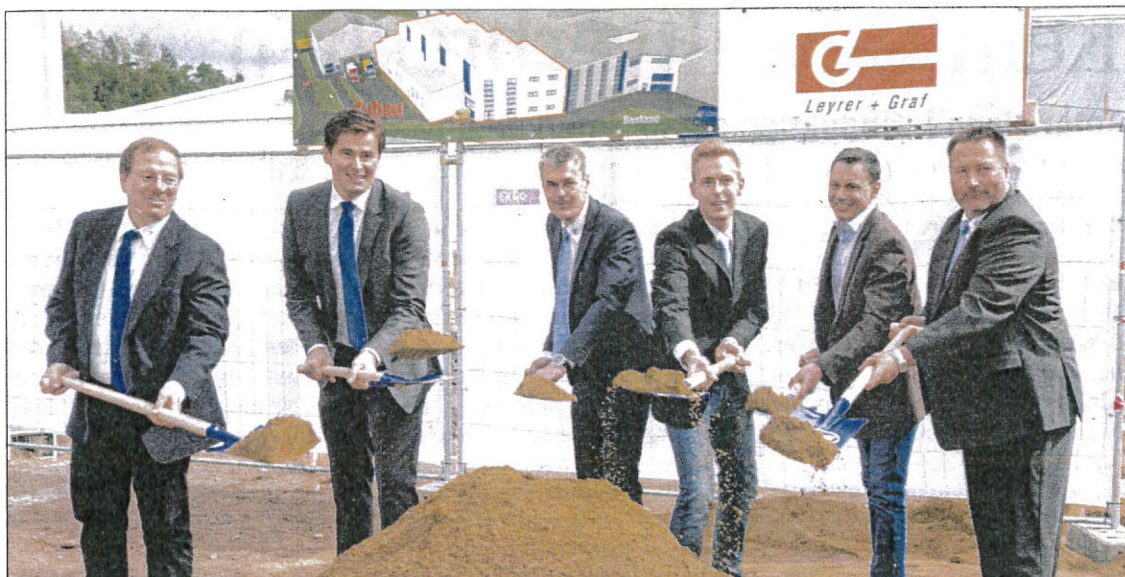
Robert Pollmann, Herbert Auer (CEO Pollmann International), Erwin Negeli (CEO Pollmann Austria), Rainer Hobiger (Pollmann - Projektleiter Hallenbau), Peter Ulrich (Geschäftsführer Leyrer & Graf) und Markus Pollmann beim Spatenstich zur neuen Halle. Foto: Michael Schwab
